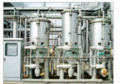
폐수 재활용 System
